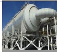
海水淡水化設備
